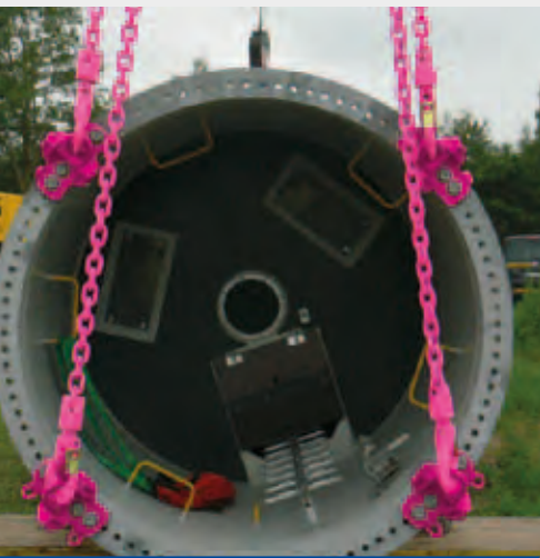
FLARIBO instalado em torre eólica
